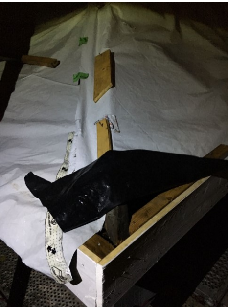
undichte Dächer wundern wenig
